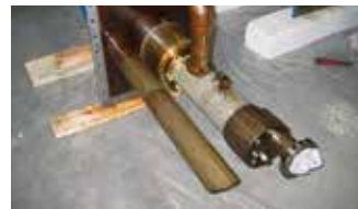
Bomba de óleo de emergência
